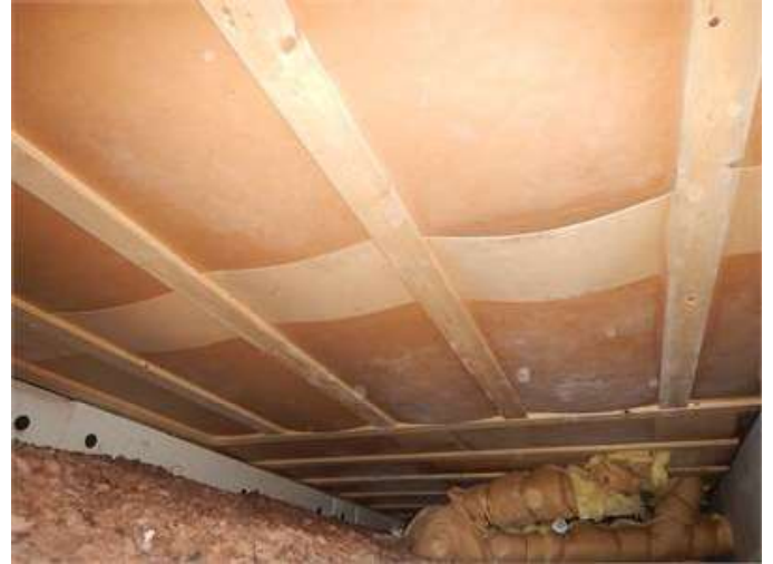
Mikrobiell påväxt på blindbotten krypgrund.
