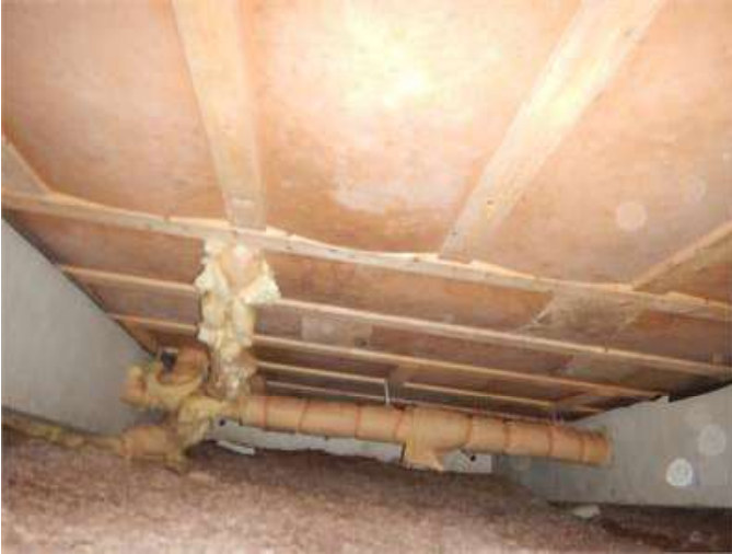
Mikrobiell påväxt på blindbotten krypgrund.
